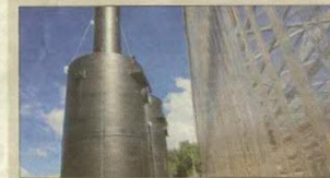
Les ajouts à l'installation comprennent un module de désodorisation avec un testeur olfactif efficace et une cheminée volontairement plus haute que la norme. (Photo J. O.)
